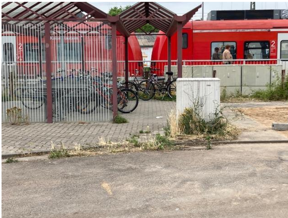
Kabelverteilerkasten auf Flst.-Nr. 1076/114; im Hintergrund die bestehenden Verteiler auf Bahngelände
