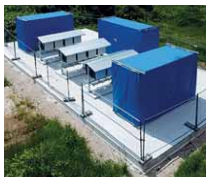
Strom für das Schul- und Sportzentrum: Ein 3.500 kWh großer Batteriespeichersystem
