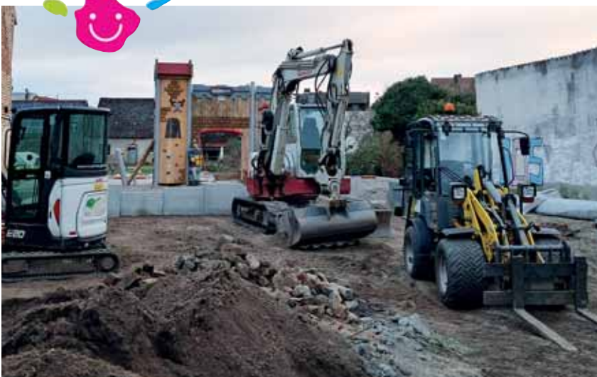
Sorgt bald für strahlende Kinderaugen: Die „Glücksburg“ auf dem Spielplatz an der Großen Kapellenstraße.
