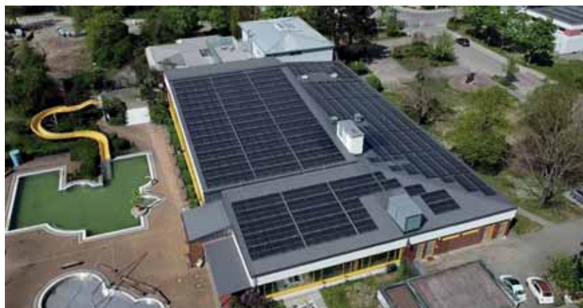
Liefert Strom, der direkt vor Ort genutzt wird: die PV-Anlage auf dem Dach des Kreisbades
